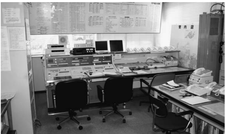
消防本部の通信指令室
