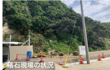
落石現場の状況
