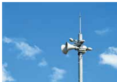
生月地区デジタル同報系防災行政無線施設整備事業 … 9,096万円
