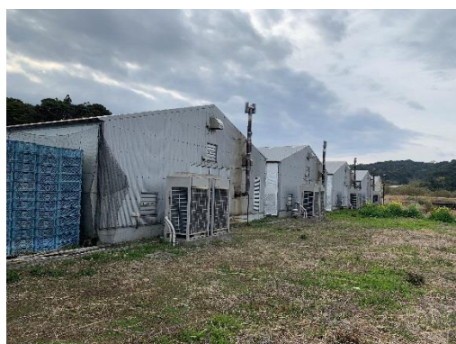
図 4-1-3 エアコン室外機
