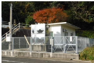
船木送水ポンプ場
