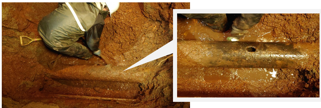
送水管（φ200）の破損状況
