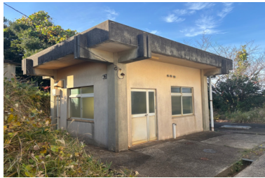
戸石川送水ポンプ場
