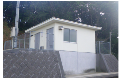
向月ポンプ場
