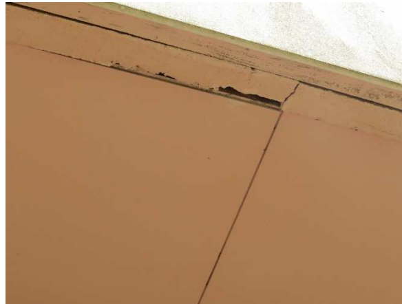
〈出入口の亀裂〉
