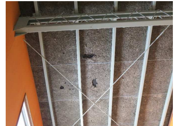
〈屋内天井の剥がれ〉
